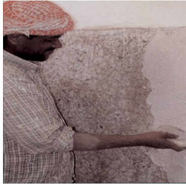
شكل رقم ( 4-2-2 ) يوضح عملية التلييس بالنورة التي تستخدم مع المدر وتشكل طابعاً عاماً للواجهات بوادي حضرموت
